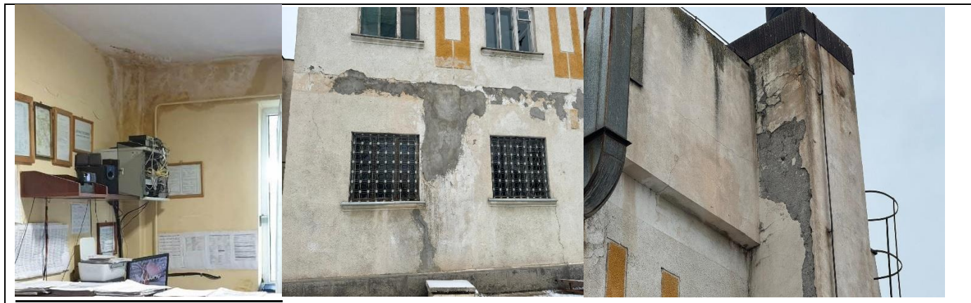
Figura 7 Deteriorări vizibile ale Clădiri administrative a DPZ
